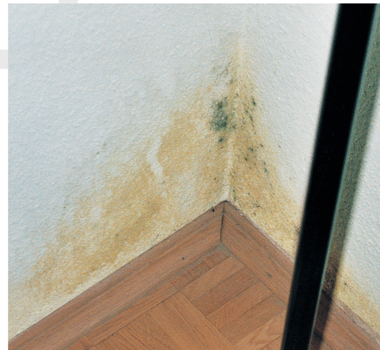
Schadensbilder, die mit dem Einbau von Thermur plus oder Thermolino der Vergangenheit angehören.
